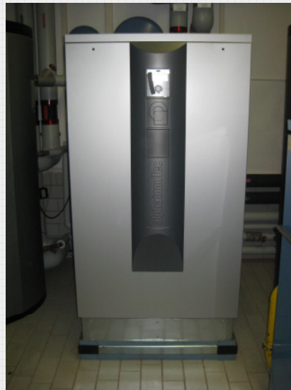
Abb. 3: Wärmepumpe (SWP 270 H, Hersteller: Alpha-InnoTec) im Heizraum
