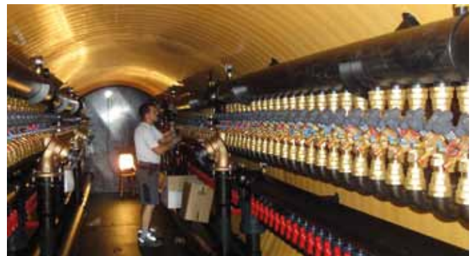
Verteilerkomponenten im Verteilerschacht
