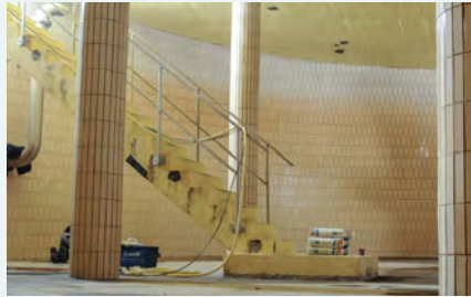
Vorher: Sanierungsbedürftiger gefliester Trinkwasserspeicher
